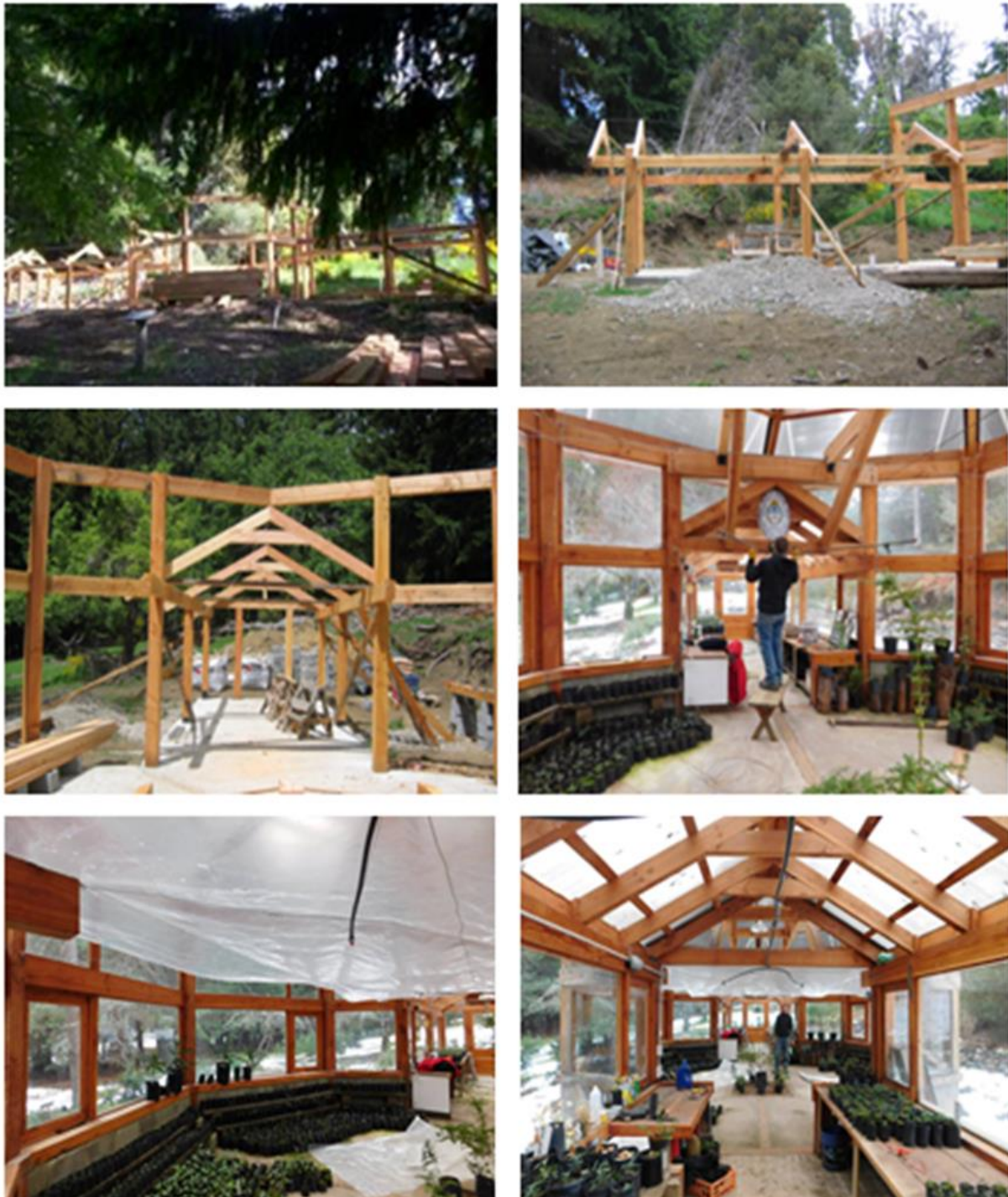
Figura 3. Basamento de bloques, estructura de madera de la isla, cubierta transparente, ubicación de mesas con plantines. Fuente: CFIV PNNH
