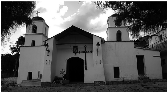
Figura 8: Fachada de la Iglesia de Nazareno, se observa la forma trapezoidal de los muros. Fuente: Fotografía de la autora.
