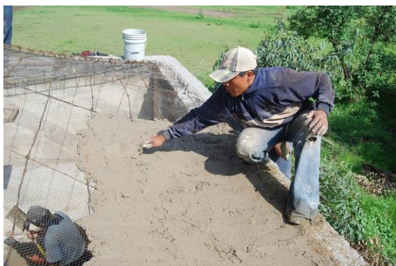
Figura 3. La primera capa de tierra vertida sobre la malla metálica. (Foto: L. Guerrero)
