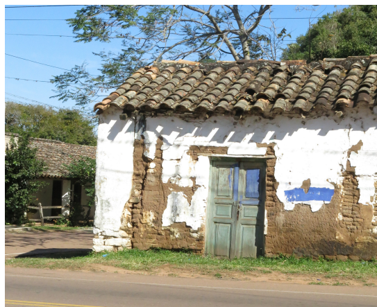
Figura 8. Esta vivienda en Caapucú muestra el proceso de deterioro ocasionado por la eliminación de la galería por el paso de la ruta.
