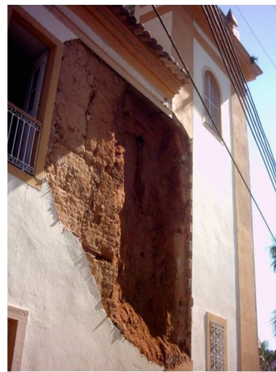
Figura 2. Area colapsada del muro, fachada Este. Agosto 2005.
