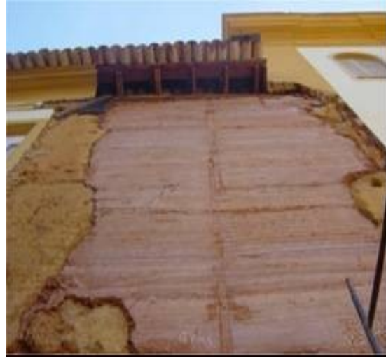
Figura 5. Vista del área colapsada al fin de la tarea de compactación. Abril 2006.
